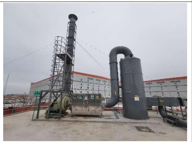
废气处理设施
