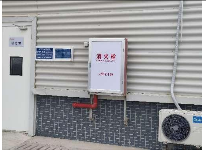
应急室内消防栓
