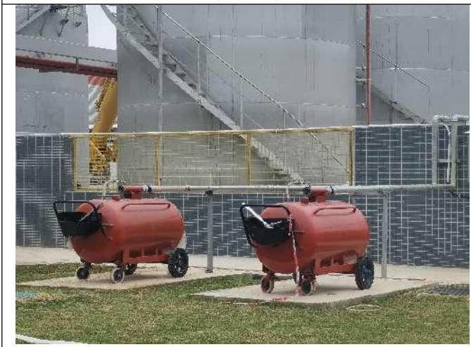
罐区泡沫灭火器
