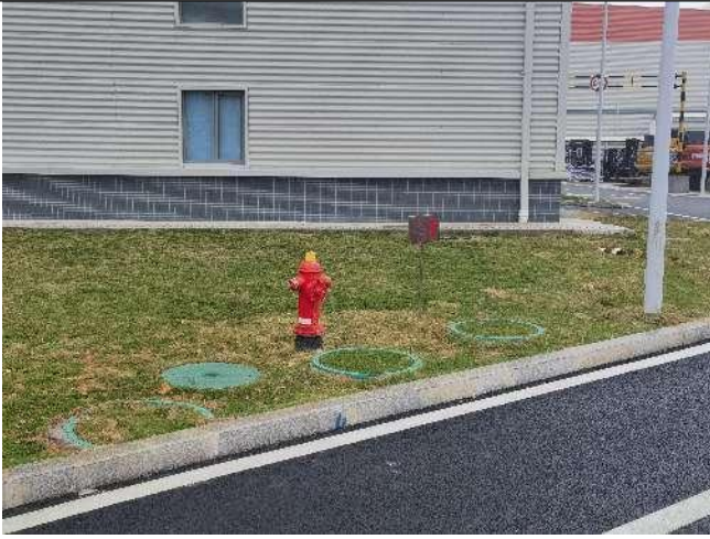
应急室外消防栓
