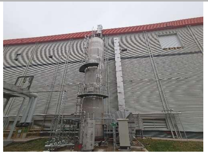
NMP 回收装置
